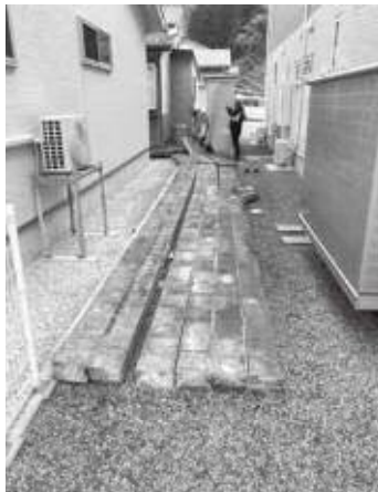
倒壊したブロック塀 (京ヶ峰)
